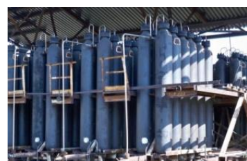
Технологическая резервная испытательной станции завода
