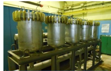
Блоки фильтров систем заправки горючим и окислителем 2Г60 и 2Г70
