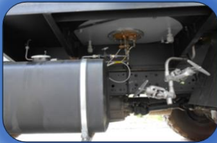
Днище парогенератора, вентили слива воды из парогенератора, горелочное устройство и вентили регулирования подачи топлива
