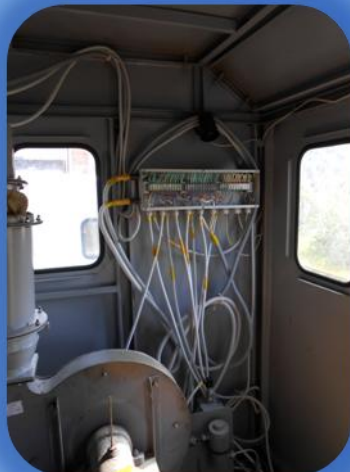
Коробка распределительная, кабели, вентилятор
