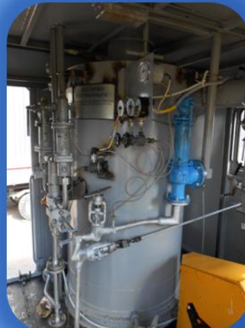
Парогенератор с коллектором и предохранительными клапанами и КИП
